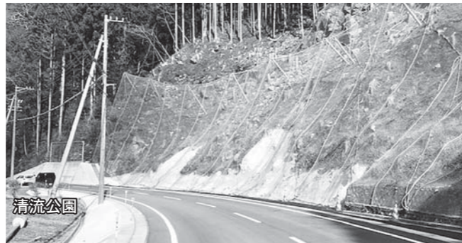
④瀬戸設楽線 東納庫 D17(清流公園横) ・清流公園横の状況です。落石対策として金属性のネットを張りしました。
