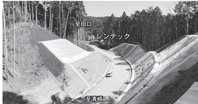
②国道257号 清崎 D2-2(安沢坂) ・現道の急カーブを緩和するため、約1kmのS字形の緩やかなカーブで道路を築造します。
